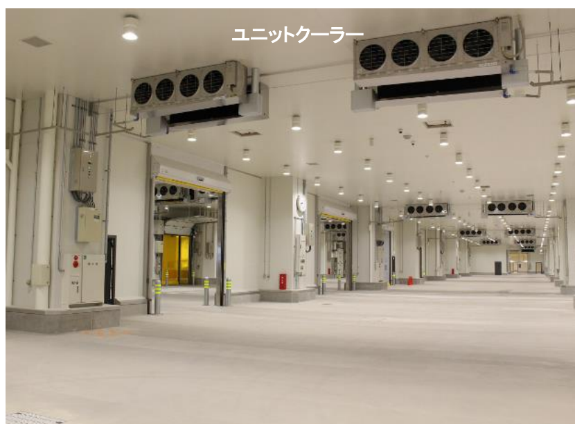
図 9 施設内に設置されているユニットクーラー
